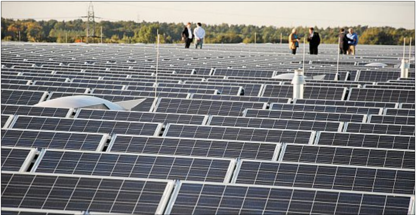
Reihe für Reihe und dicht an dicht: Auf jeder der zwei 19 000 Quadratmeter großen Nibler-Logistikhallen an der Europastraße befinden sich jetzt 3486 Fotovoltaik-Module. Sie sollen mehr als 400 Lehrter Haushalte mit Strom versorgen. Gückel
